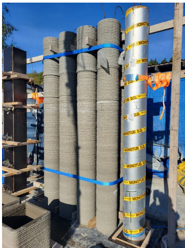
Figur 18: 3D-utskrivna pelarformar och form i hårdpapp före gjutning med SKB. Längst t.v. skymtar träformen med kvadratisk tvärsnitt för mätning av form tryck och längst ned till vänster rätblocket ur vilket provkroppar för beständighetsprovning borrades.
